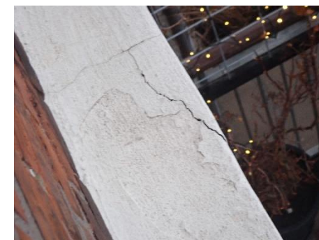
Revne i gesims
