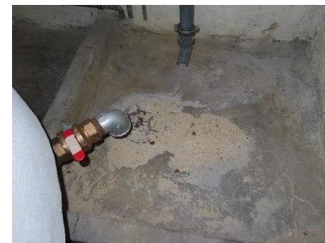
Gulvafløb i kælder
