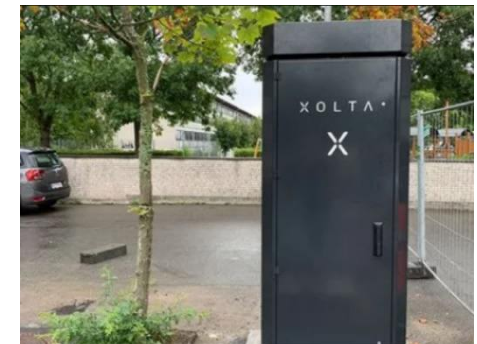
Eksempel på batterianlæg
