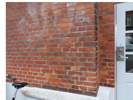
Udvaskede fuger mod gade
