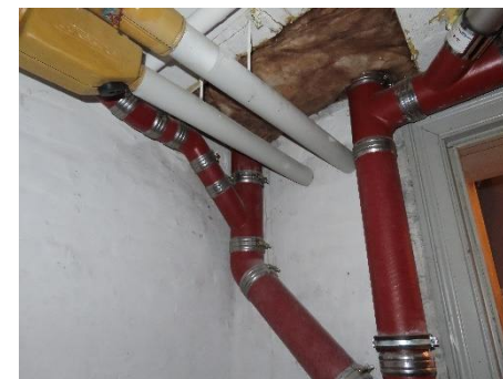
Faldstamme i kælder
