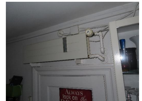
Radiator over køkkentrappedør i lejlighed
