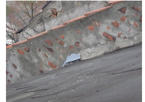
Brandkam med revner i puds lagt ud over løskanter
