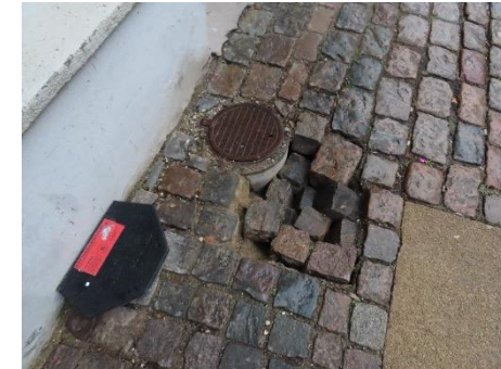
Underminering af belægning ved tagnedløbsbrønd
