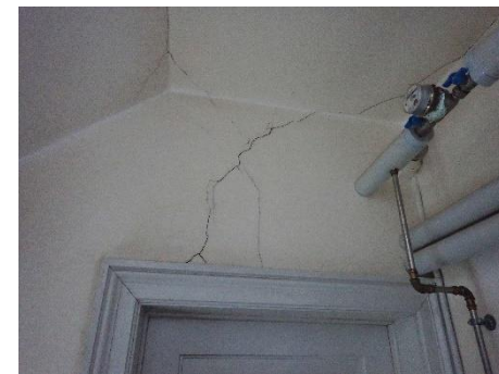
Sætningsrevner over dør
