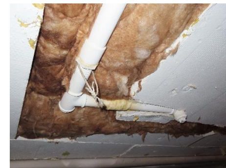
Gasrør i kælder
