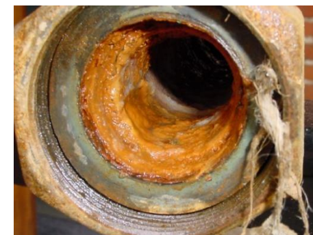
Eksempel på biofilm med slimdannelse i vandrør
