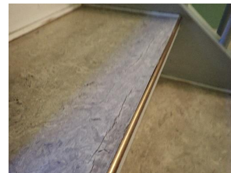
Linoleum med revner i overfladen
