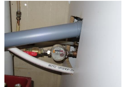
Vandinstallation i kælder
