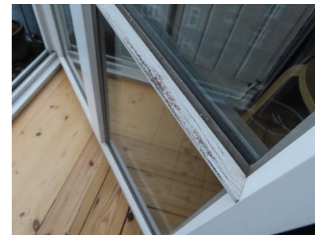
Nedbrudt maling på altandør
