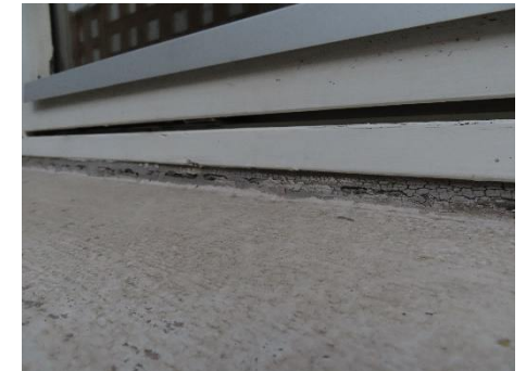
Ældre udtørret vinduesfuge
