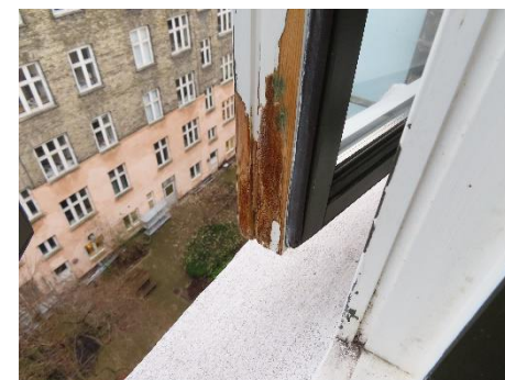
Rådskade i vinduesramme mod gård
