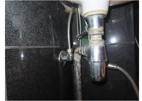
Vandinstallation i badeværelse
