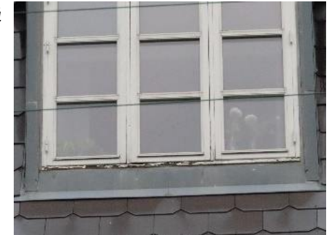
Nedbrudt maling på kvistvindue
