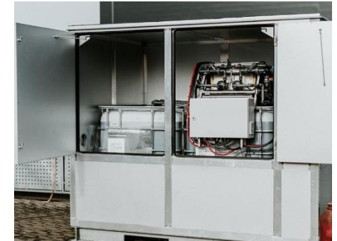
Eksempel på batterianlæg
