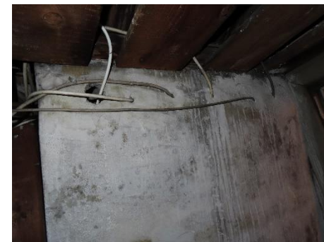
Ventilationskanaler på loftet
