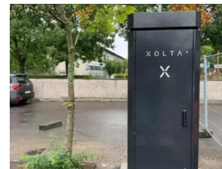
Eksempel på batterianlæg
