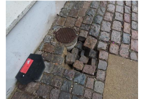
Underminering af belægning ved tagnedløbsbrønd
