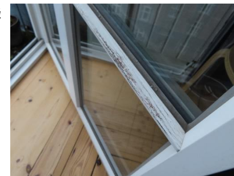
Nedbrudt maling på altandør
