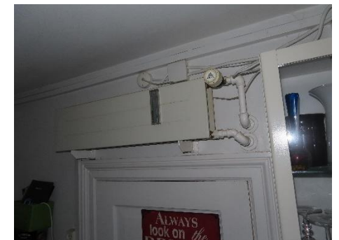
Radiator over køkkentrappedør i lejlighed
