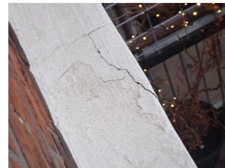
Revne i gesims
