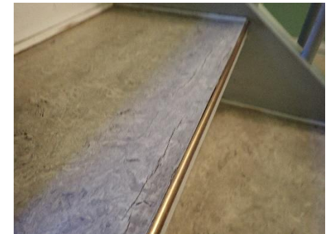
Linoleum med revner i overfladen
