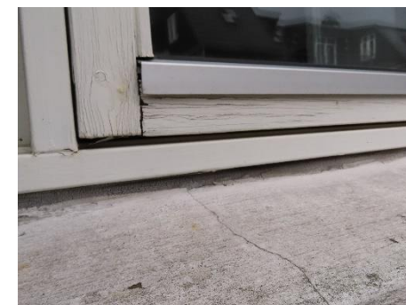
Forskudt tapsamling og vindridser i sideramme og bundstykke
