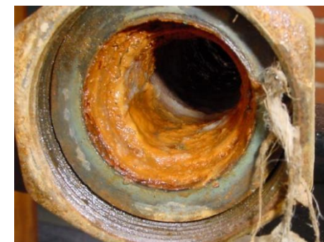
Eksempel på biofilm med slimdannelse i vandrør
