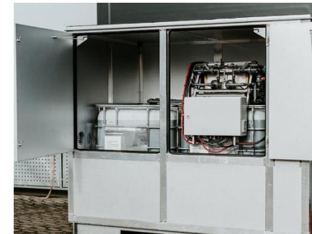
Eksempel på batterianlæg
