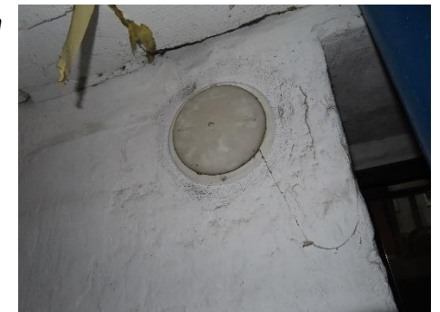
Ventil til ventilation af kælderen til det fri
