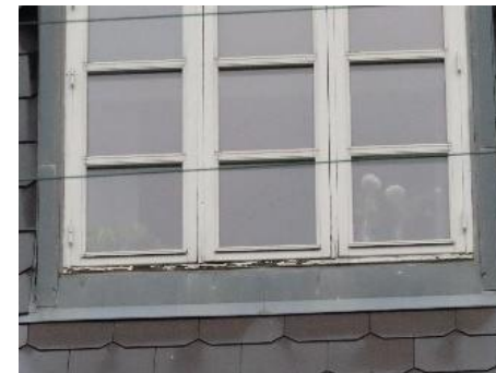
Nedbrudt maling på kvistvindue
