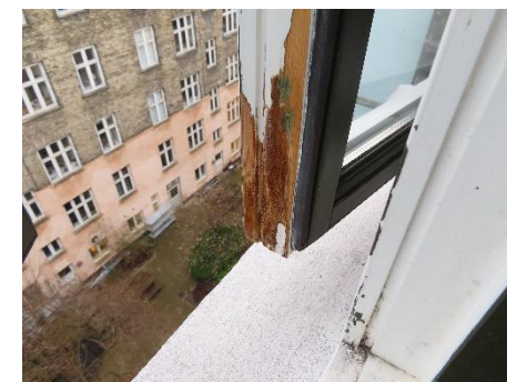
Rådskade i vinduesramme mod gård
