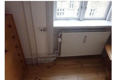
Radiator i lejlighed
