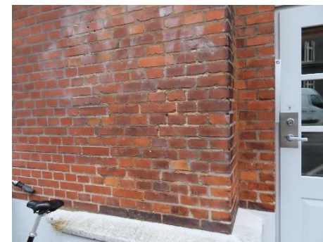
Udvaskede fuger mod gade
