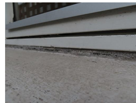
Ældre udtørret vinduesfuge
