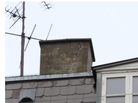
Skorsten med afskalning og revner
