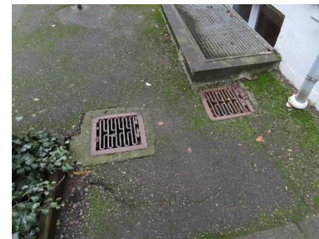
Overfladerist i gård
