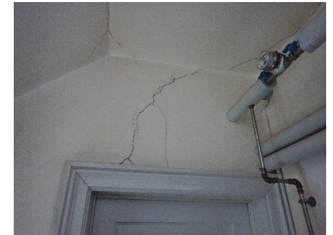
Sætningsrevner over dør
